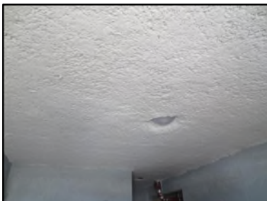
Photo N° 609 ECH-N°1 FLOCAGE -- COULOIR DE CAVE Plafonds Blanc cotonneux
